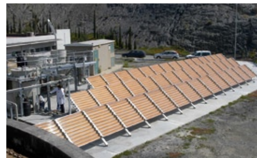
Planta de fotocatalisis. Photocatalysis Plant.
