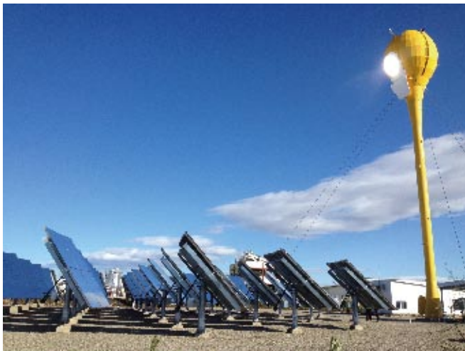
La planta de AORA Solar en la Plataforma Solar de Almería.
