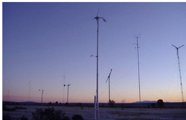
Instalaciones de eólica en el CEDER-Soria.
