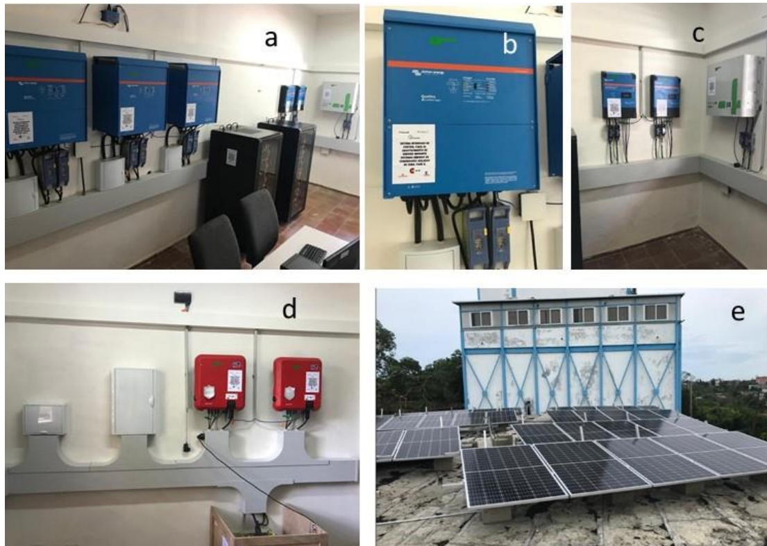
Figura 5. a) Sala de baterías, convertidores y c) Dos reguladores solares FV marca Victron (azules) y regulador eólico marca Bornay; d) Inversores solares FV de conexión a red marca SMA, modelo Sunny Boy; e) Vista del generador FV ubicado en la azotea (Fuente: CUBAENERGÍA); b) Inversor de batería marca Victron, modelo Quattro.
