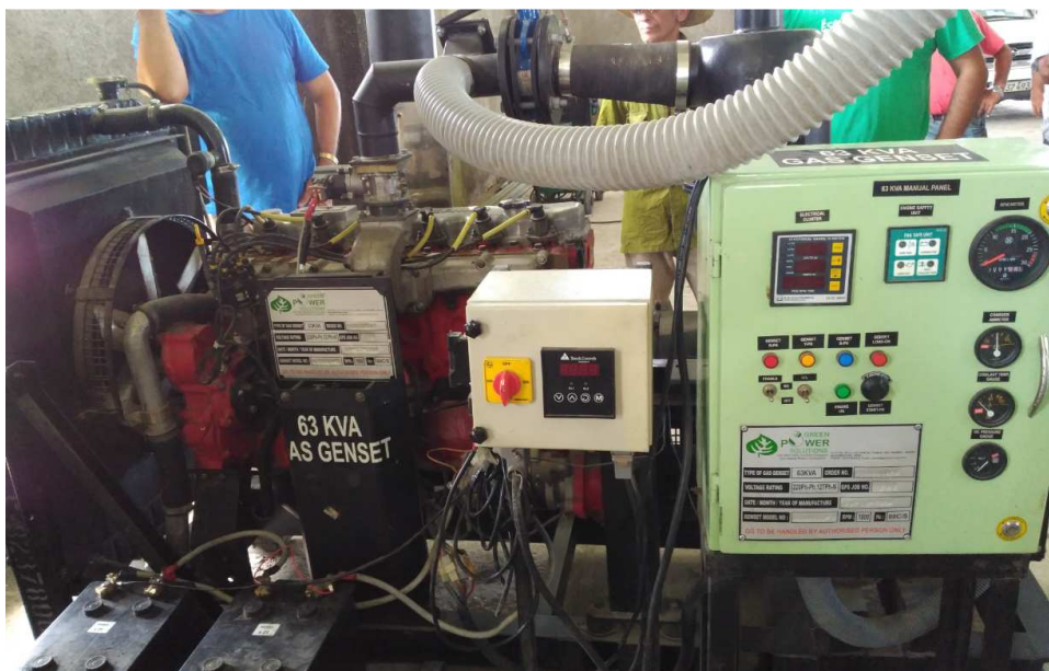
Figura 8. Grupo electrógeno en la instalación de la La Veguera
