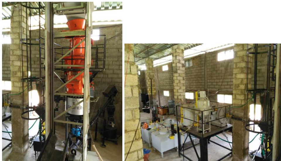
Figura 6.3. Gasificador (izquierda) y sistema de depuración y acondicionamiento del gas (derecha)
