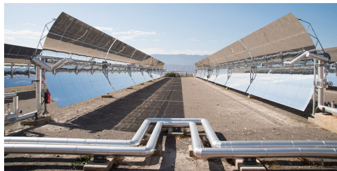
Fig. 1. North view of the TCP-100 solar field at Plataforma Solar de Almería.
