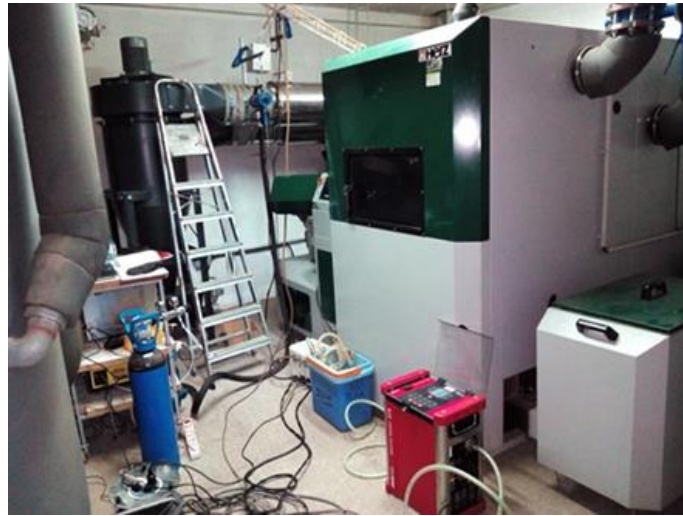
Figura 13. Caldera de biomasa monitorizada en Fabero (León)
