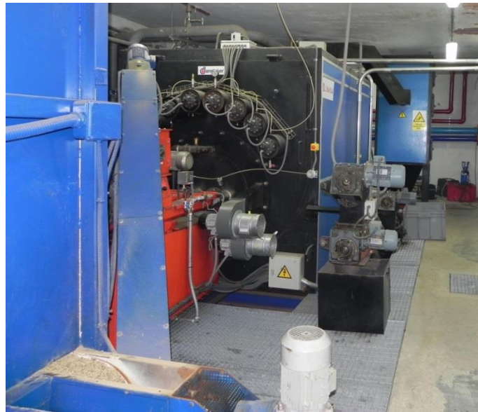
Figura 9. Caldera de combustión en parrilla fija de 1 MW t en Las Navas del Marqués.
