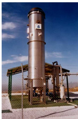
Ilustração 12: Tocha instalada no aterro
