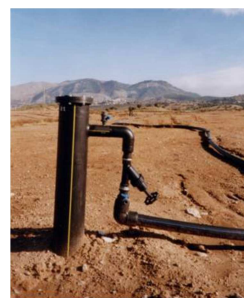
Ilustração 10: Cabeça de poço de extração externa
