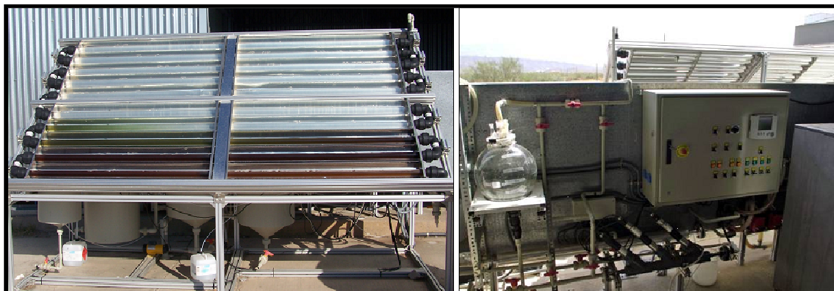
Figura 7. Fotografía de los cuatro módulos de concentradores CPC durante un ensayo de foto-Fenton (izda.) e interior de la caseta que protege al tanque de recirculación, los sensores, el sistema de calefacción y refrigeración y el cuadro eléctrico (dcha.).
