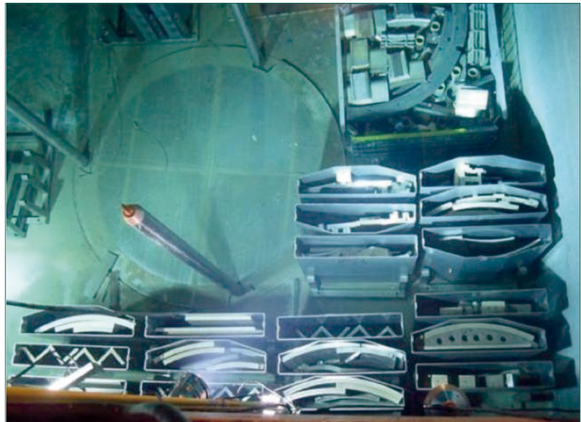
Figura 1. Inserts y cestas llenos en fondo de piscina de combustible gastado.
