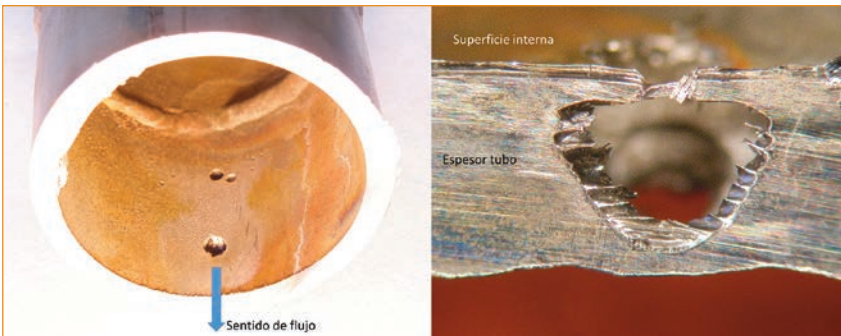
Figura 6. Sección transversal de una tubería cercana a la unión soldada. Se aprecia la formación de una cavidad asociada a un proceso de ataque por corrosión microbiológica.
