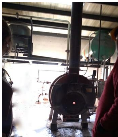
Figura 3.16. Caldera para secado de madera en el Centro Foresto Industrial Arrayanal, Jujuy, Argentina. Fuente: propia.
