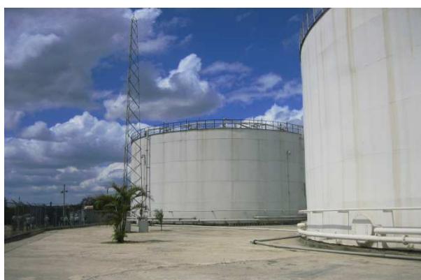
Ilustración 7: Digestores de la planta de tratamiento de vinazas de Ron Brugal
