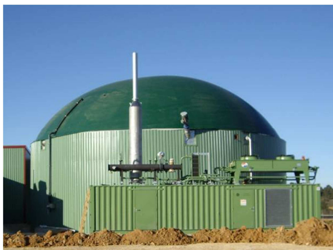
Ilustración 8: Planta de biogás realizada en el marco de PROBIOGÁS
