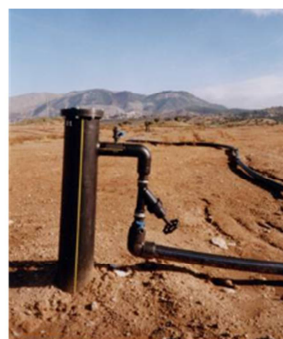
Ilustración 10: Cabezal de pozo de extracción externo
