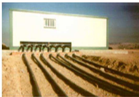
Ilustración 13: Estación de regulación y medida
