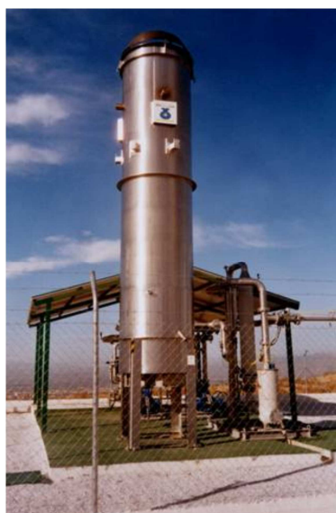
Ilustración 12: Antorcha instalada en vertedero
